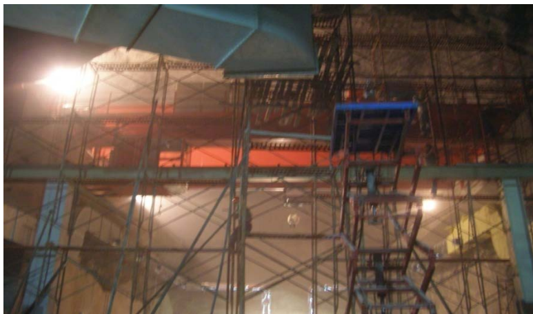
图 1#厅大门防火墙
