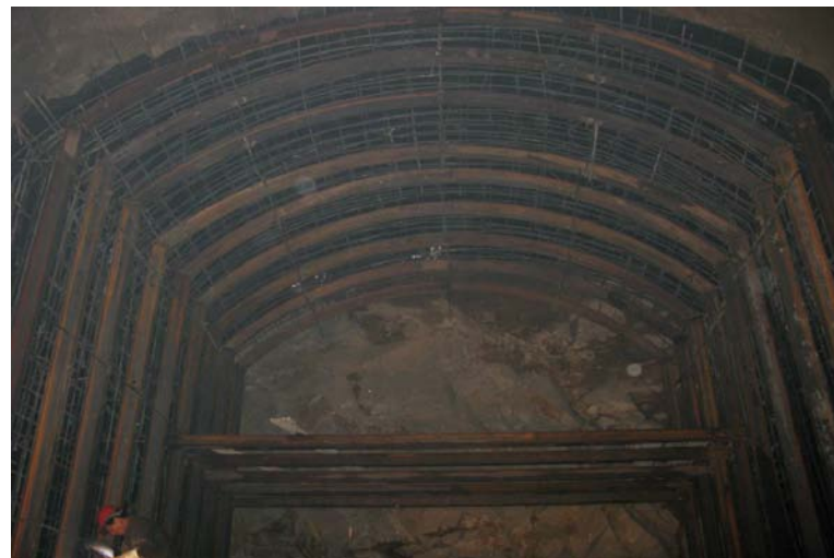
图 3#隧道塌方段处理
